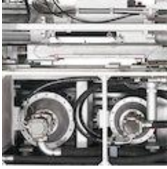
Voith pump and gears and Siemens motor
